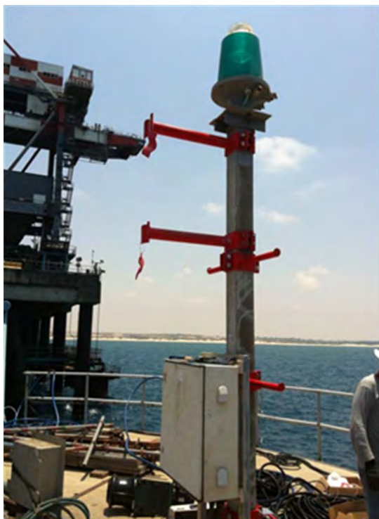
תמונה מס' 1-13 – התקנת מחברים לעמוד מד הרוח על עמוד התאורה שעל דולפין הרתיקה שבקצה מזח הפחם
