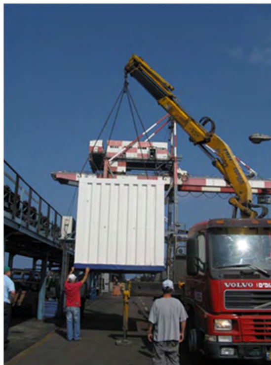
תמונה מס' 1-12 - הצבת חדרון המחשבים בקצה המזרחי של מזח הפחם, מתחת למסוע הפחם
